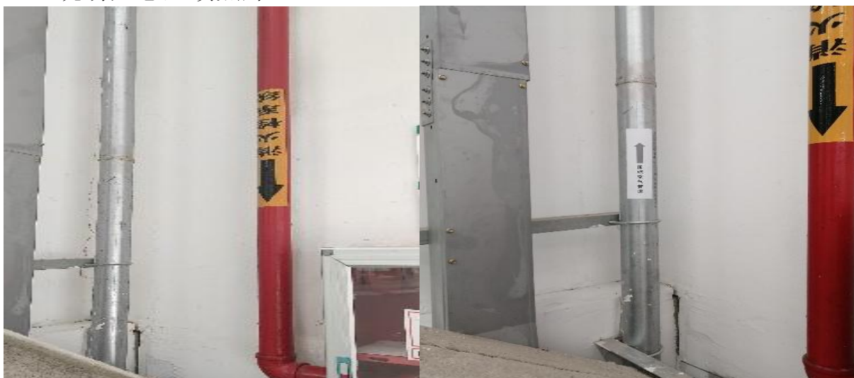
车间压缩空气管道上无物料及方向标识（整改前、整改后）
