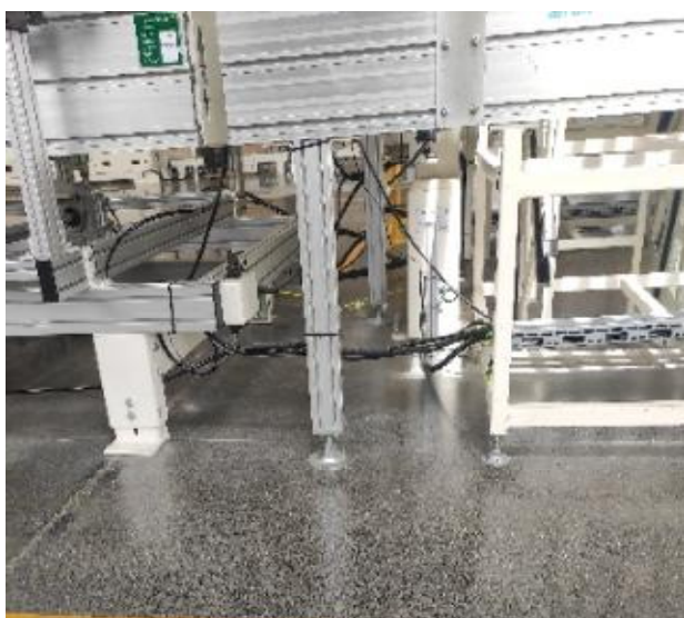
车间部分设备接地不全（整改后）
