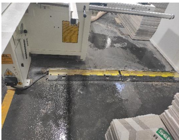
板材切割间设备未静电接地（整改后）
