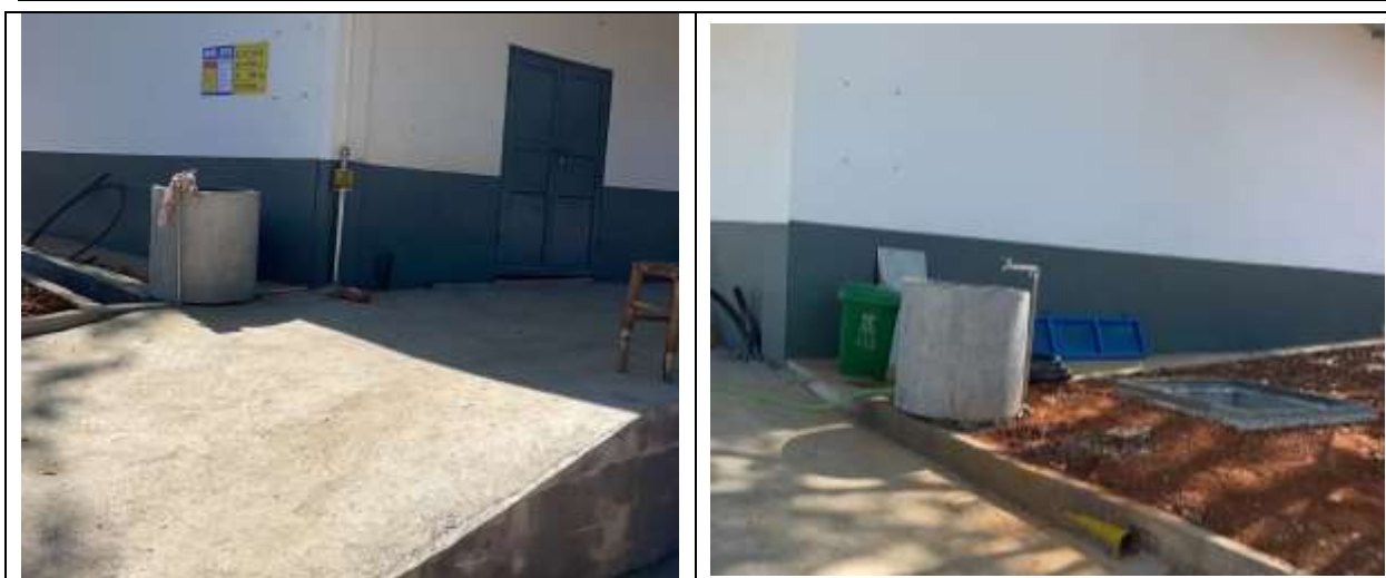
已完善消防水池
