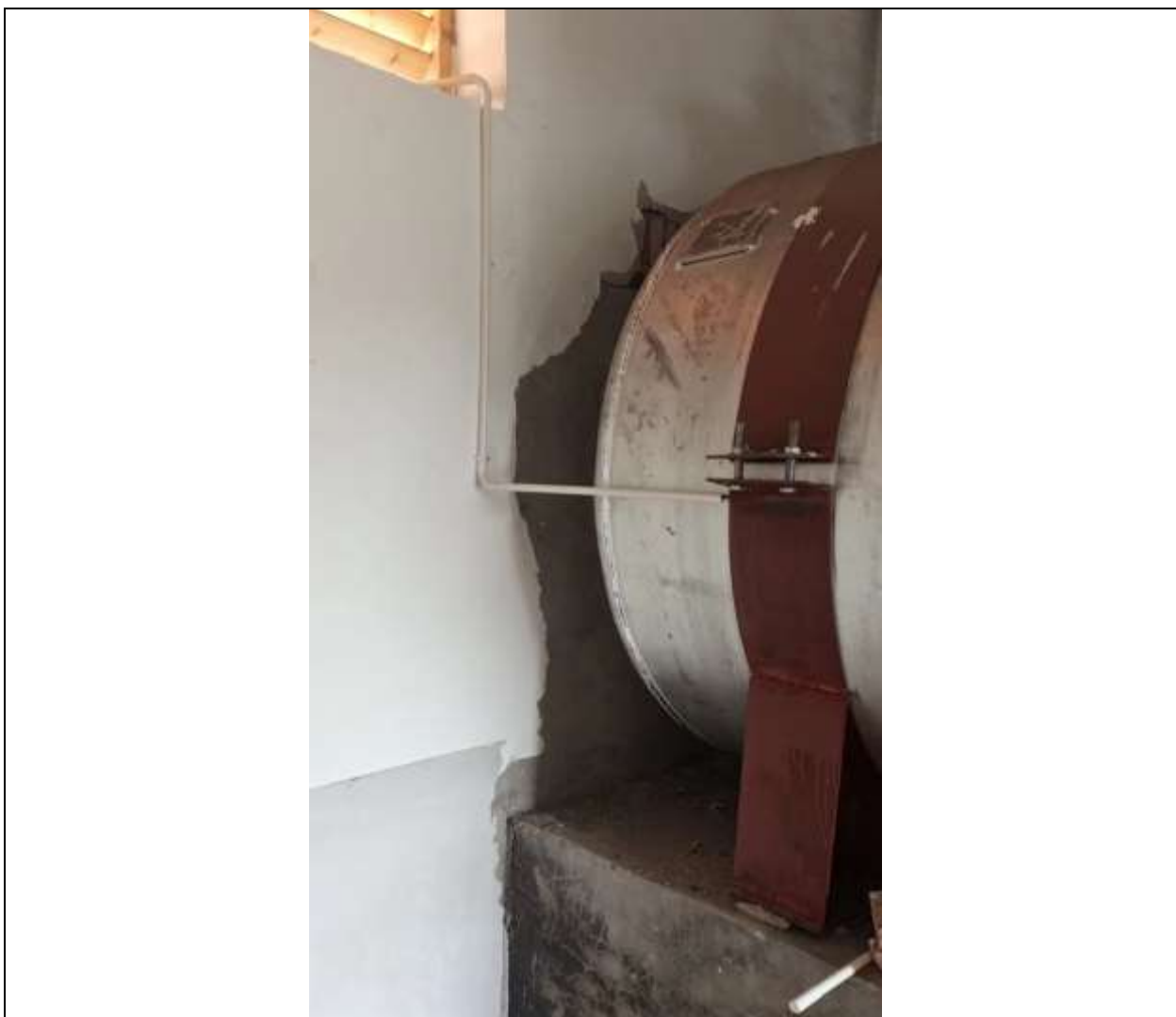
28 号酒精储罐已可靠静电接地
